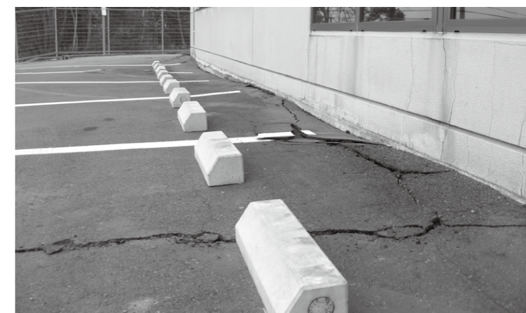
地割れのできた八天の里駐車場
