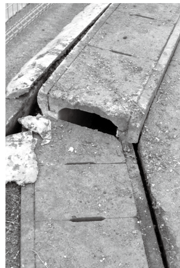
側溝が陥没(八天の里)
