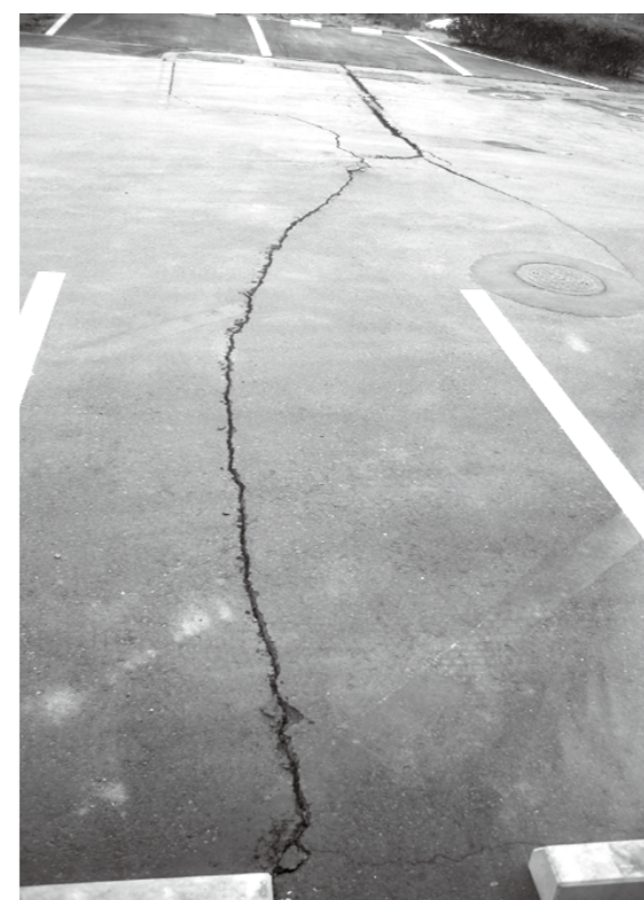
地割れ(八天の里駐車場)
